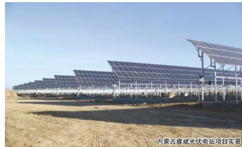
内蒙古睿斌光伏电站项目实景图
