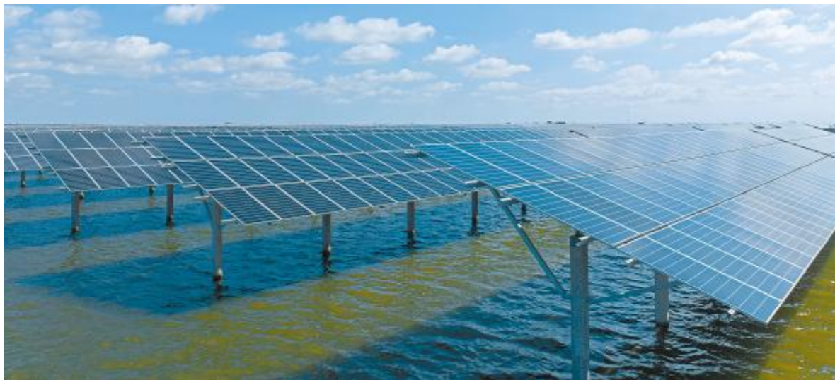
通威“渔光一体”项目
